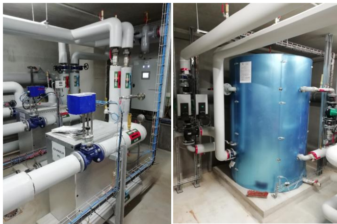
Sous-station d'un RCU de 117 logements
